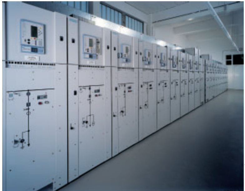
Bild 1 Mittelspannungsschutz mit SIPROTEC-Geräten
